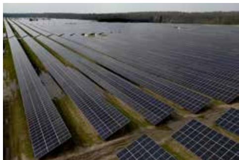
Solcelleanlæg ved Aabenraa.
